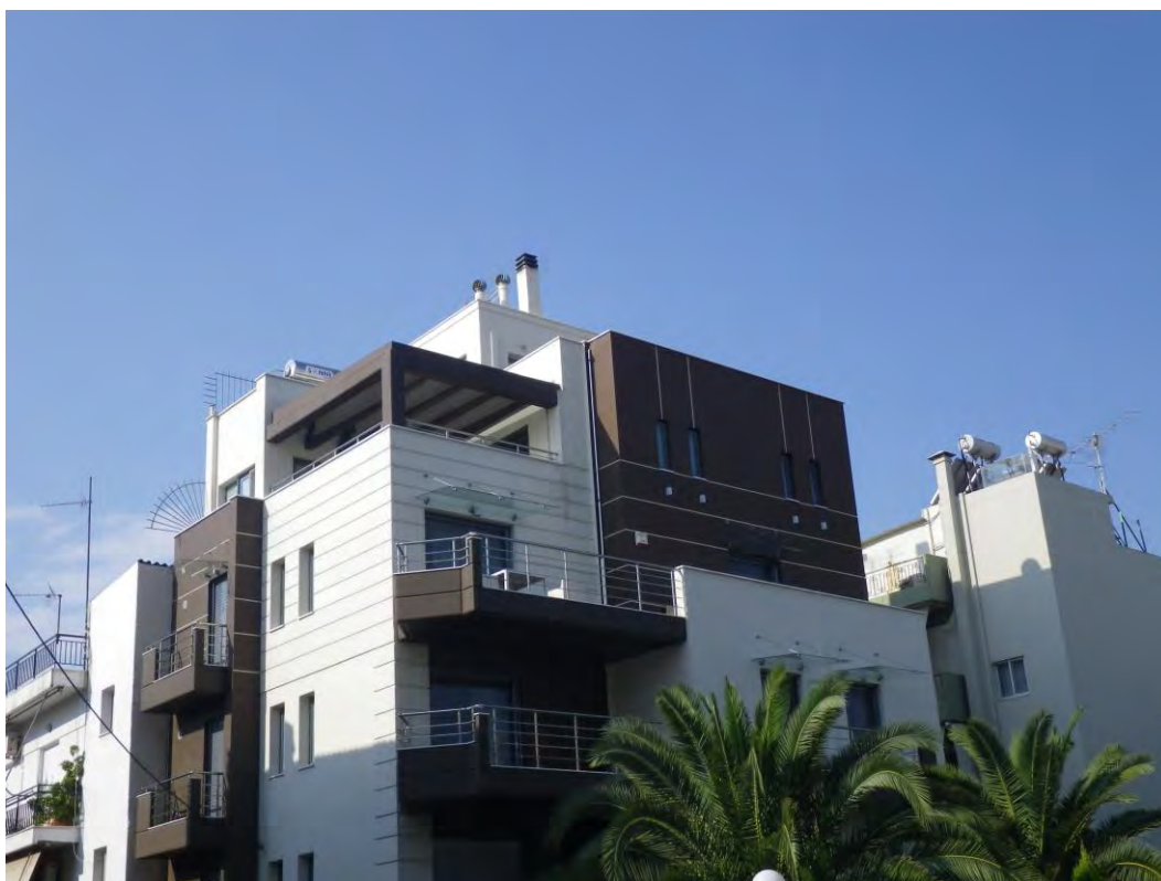
Φωτογραφία ΙΑ.1: Άποψη του σταθμού βάσης κινητής τηλεφωνίας της εταιρείας VODAFONE-PANAFON ΑΕΕΤ. επί της συμβολής των οδών Κύμης 31 και Καππαδοκίας, στο Δήμο Ιλίου Αττικής
