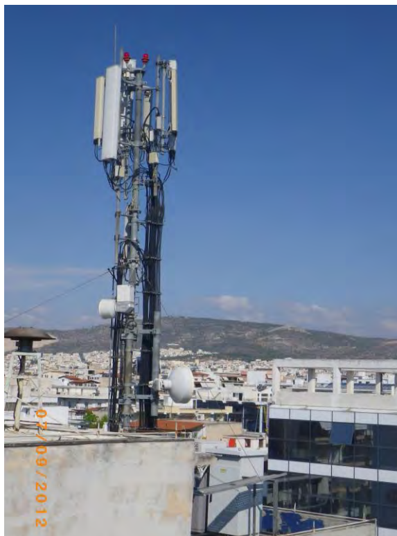
Φωτογραφία Θ.1: Άποψη του σταθμού βάσης κινητής τηλεφωνίας της εταιρείας COSMOTE Α.Ε. επί της συμβολής των οδών Ιδομενέως & Πριάμου, στο Δήμο Ιλίου Αττικής
