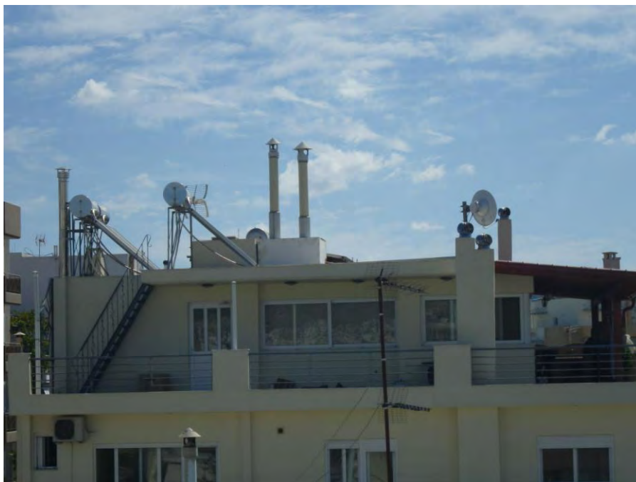
Φωτογραφία KB.1: Άποψη του σταθμού βάσης κινητής τηλεφωνίας της εταιρείας VODAFONE-PANAFON ΑΕΕΤ επί των οδών Ψαρρού και Γαργαλιάνων 10, στο Δήμο Ιλίου Αττικής
