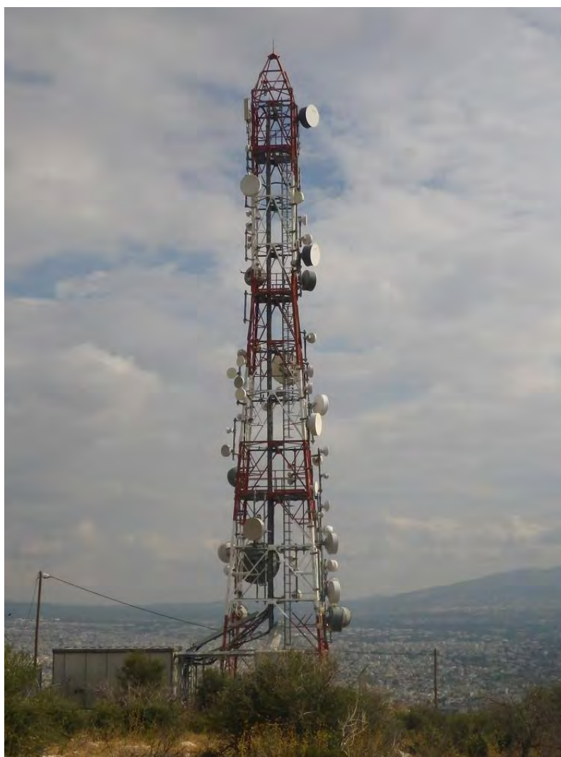
Φωτογραφία Z.1: Άποψη του σταθμού βάσης κινητής τηλεφωνίας της εταιρείας COSMOTE Α.Ε. στο ΥΨΩΜΑ ΖΑΧΑΡΙΤΣΑ, στο Δήμο Ιλίου Αττικής
