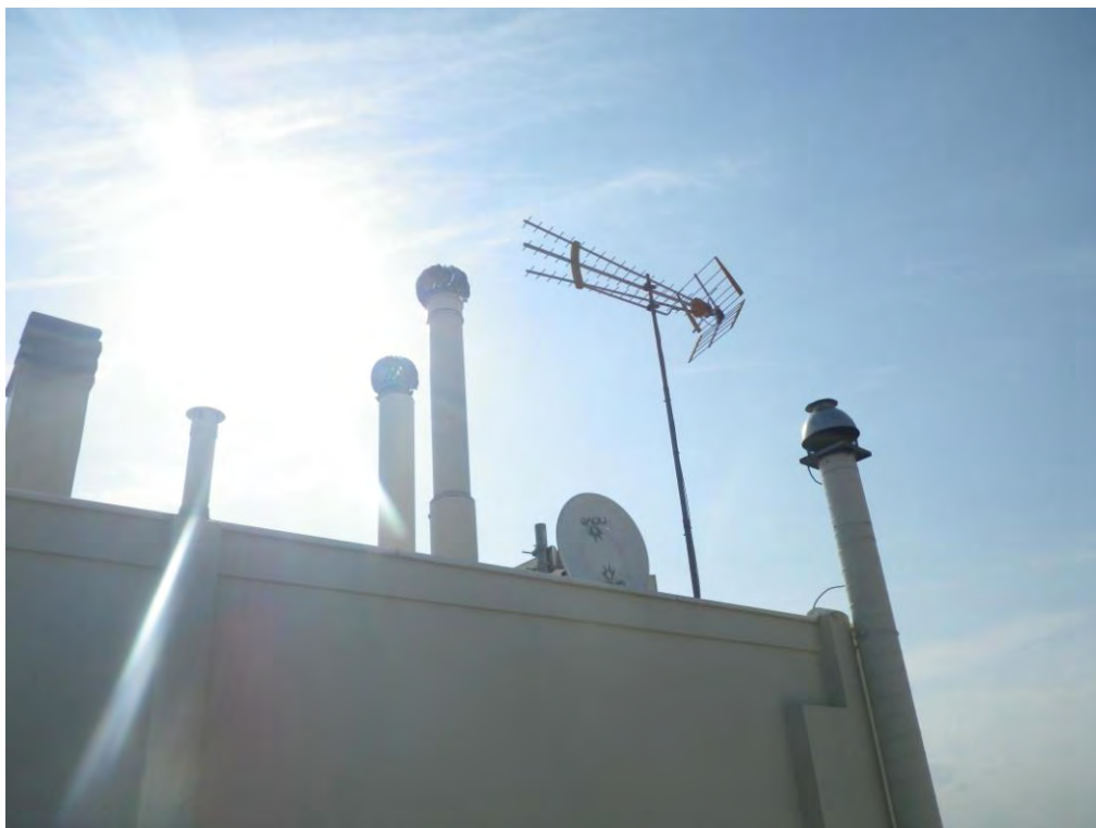
Φωτογραφία ΙΑ.2: Αποψη του σταθμού βάσης κινητής τηλεφωνίας της εταιρείας VODAFONE-PANAFON ΑΕΕΤ. επί της συμβολής των οδών Κύμης 31 και Καπαδοκίας, στο Δήμο Ιλίου Αττικής
