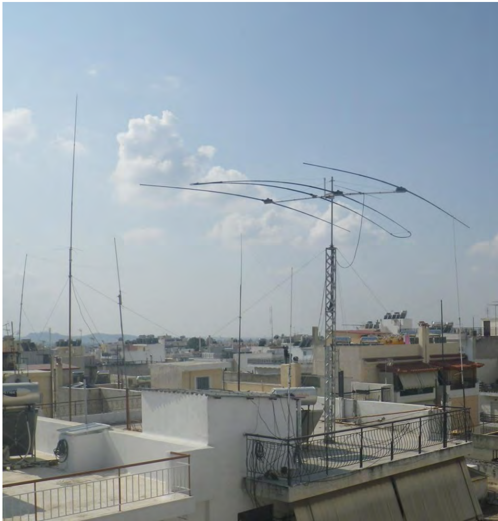
Φωτογραφία Ι.2: Άποψη του ραδιοερασιτεχνικού σταθμού στην οροφή κτιρίου έναντι του σταθμού βάσης κινητής τηλεφωνίας επί της οδού Κρυσταλλοπηγής 49Α, στο Δήμο Ιλίου Αττικής
