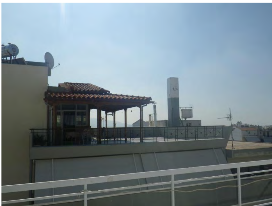
Φωτογραφία ΙΘ.1: Άποψη του σταθμού βάσης κινητής τηλεφωνίας της εταιρείας VODAFONE PANAFON ΑΕΕΤ επί της συμβολής των οδών Πετροπούλεως 92 και Συρράκου, στο Δήμο Ιλίου Αττικής
