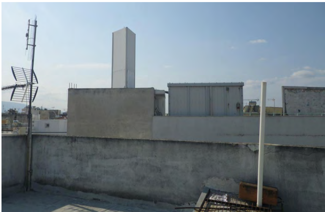
Φωτογραφία ΚΑ.1: Άποψη του σταθμού βάσης κινητής τηλεφωνίας της εταιρείας VODAFONE-PANAFON Α.Ε.Ε.Τ. επί της συμβολής των οδών Φυλίδων 1 και Θηβών, στο Δήμο Ιλίου Αττικής
