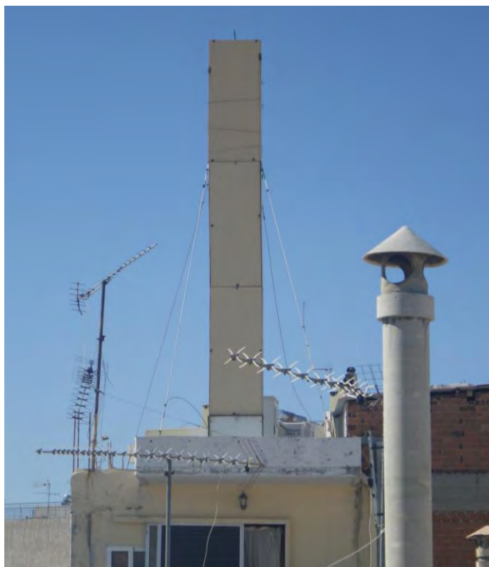
Φωτογραφία ΙΗ.1: Αποψη του σταθμού βάσης κινητής τηλεφωνίας της εταιρείας COSMOTE Α.Ε επί της συμβολής των οδών Παλατιανής και Βυζαντίου, στο Δήμο Ιλίου Αττικής
