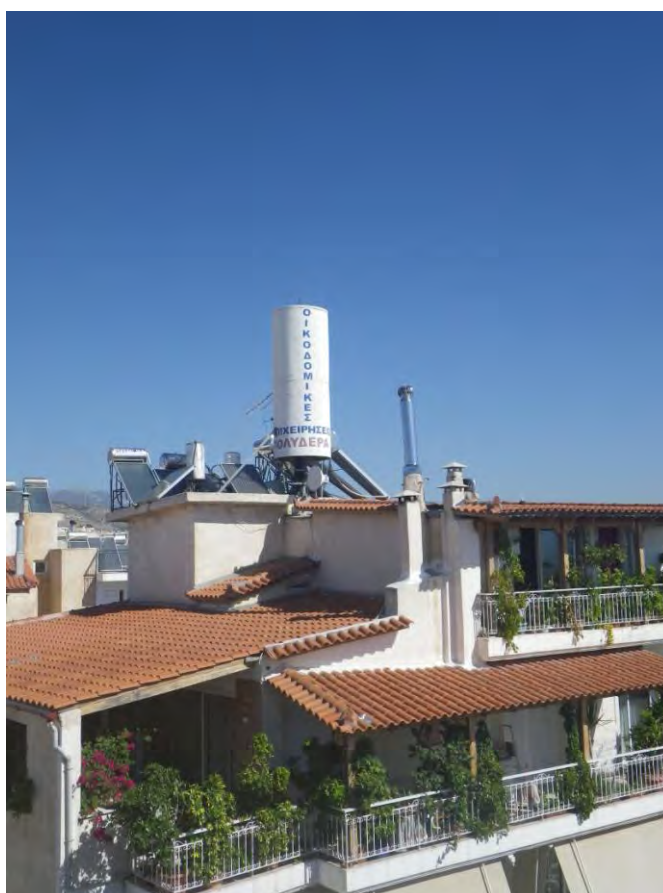
Φωτογραφία Ε.1: Άποψη του σταθμού βάσης κινητής τηλεφωνίας της εταιρείας WIND ΕΛΛΑΣ ΤΗΛΕΠΙΚΟΙΝΩΝΙΕΣ ΑΕΒΕ επί της οδού Καντακουζηνού 18-20, στο Δήμο Ιλίου Αττικής
